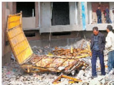
坠地后吊篮被摔粉碎
