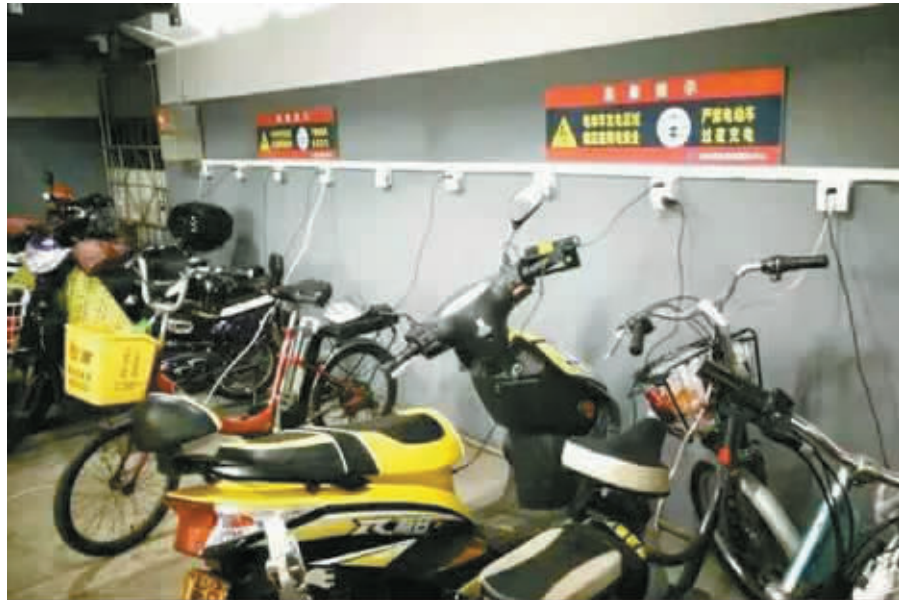
楼道里停放着多辆正在充电的电动自行车,墙上的指示牌提醒车主严禁过度充电
