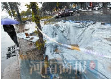
人行道上的大坑四周已经拉起了警戒线
