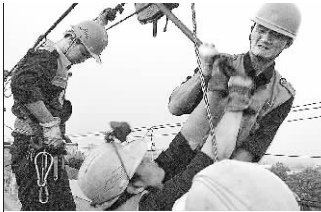
7月29日,郑州供电段安阳供电车间职工更换京广线鹤壁至淇县间烧损的接触网承力索。奥运前夕,该段集中人力,对有关安全隐患的设备进行彻底整治。③3 高国桥 摄
