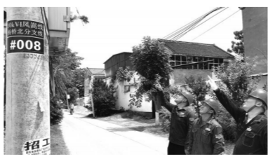
国网睢县供电公司营销稽查班班长经智皓带领稽查班同事，在董店乡杨桥村现场排查窃电户。
