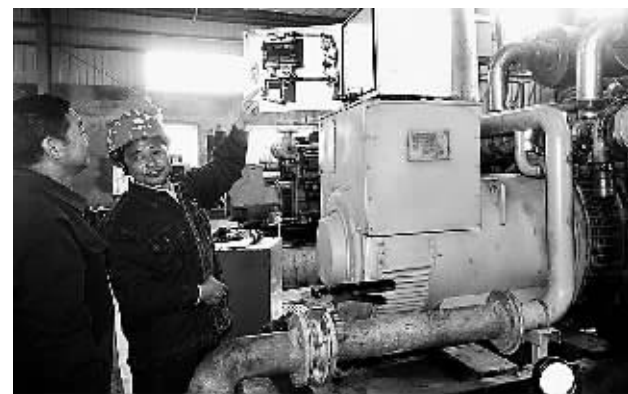
10月28日,舞钢供电局技术人员向河南瑞祥农牧有限公司职工介绍发电机线路维护知识。该公司将养殖产生的有机废弃物转变为沼气加以利用,发电量可满足公司日常生产用电的六成以上。③2 王尧 摄
