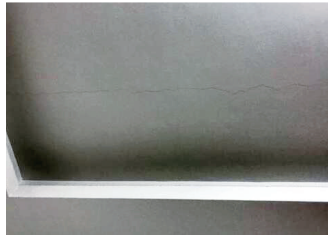
居民家中墙出现裂缝
