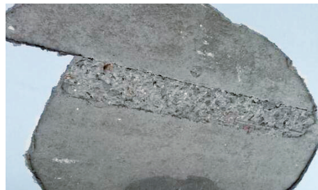
居民家中墙皮脱落
