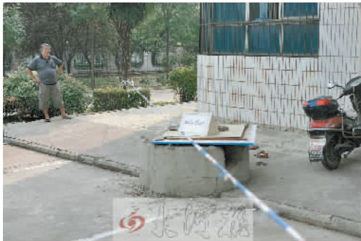
“肇事井”已加盖木板并设置了安全提示牌
